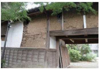
江藤家住宅長屋門の被災状況
